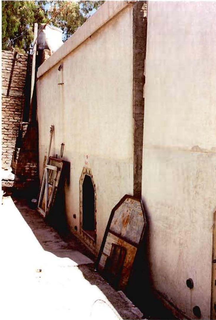
Figura 4 : Hundimiento diferencial (0.30 – 0.40 m) de las piletas de almacenamiento de vino de una pequeña bodega localizada a unos pocos centenares de metros del sitio anterior. El hundimiento fue causado por una severa licuefacción de suelos (superficial) gatillada por el terremoto de Cauçete. Fotografía: 17/12/1999.
