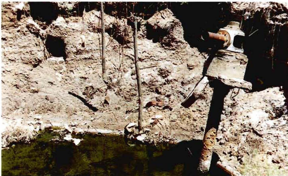
Figura 2 : Detalle de la manifestación de subsidencia mostrada en la figura anterior. Observar la posición del remanente de la bomba de extracción y de la cerca divisoria con posterioridad al evento de hundimiento diferencial. Fotografía: 17/12/1999.
