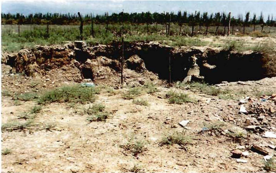
Figura 1 : Evidencia de subsidencia superficial en El Pastal (Diámetro: > 10 m – Profundidad: ≈ 3m). Notar el significativo colapso telescópico del revestimiento del pozo. Fotografía: 17/12/1999.
