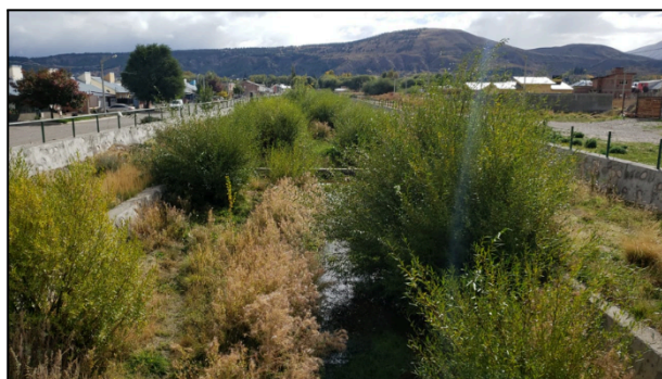
Abril de 2021 – Cauce principal sin mantenimiento
