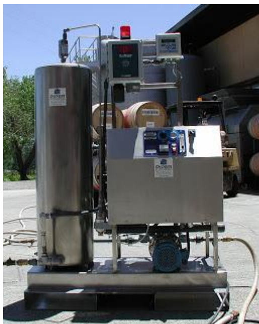
Figura 46: Utilización de ozono en bodega (Vinos y viñedos, 2012)
